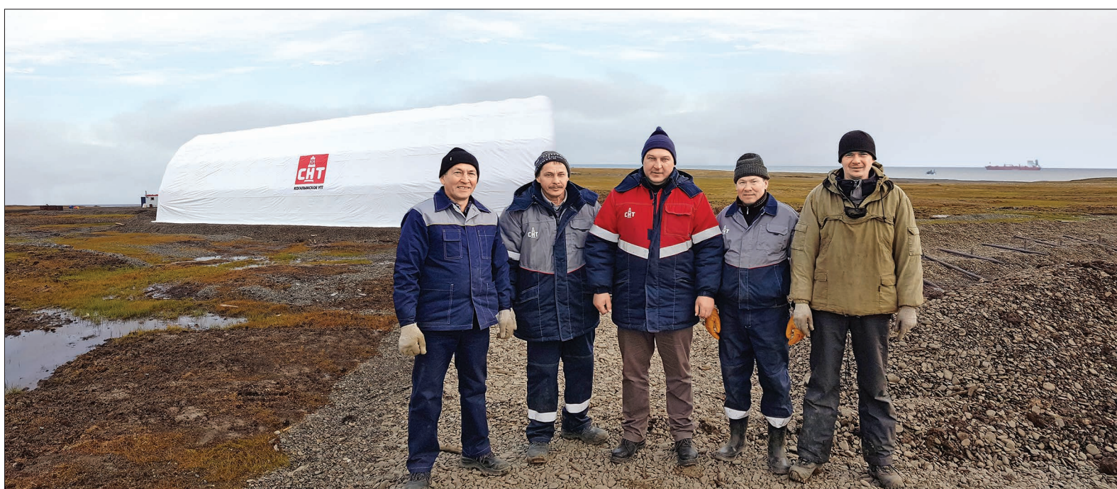
«Когалымское УТТ» установило на полуострове Таймыр первое временное сооружение — пневмокаркасный ангар для техники.
