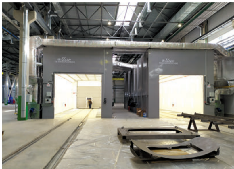
Покрасочные камеры уже используются в режиме отладочной эксплуатации
